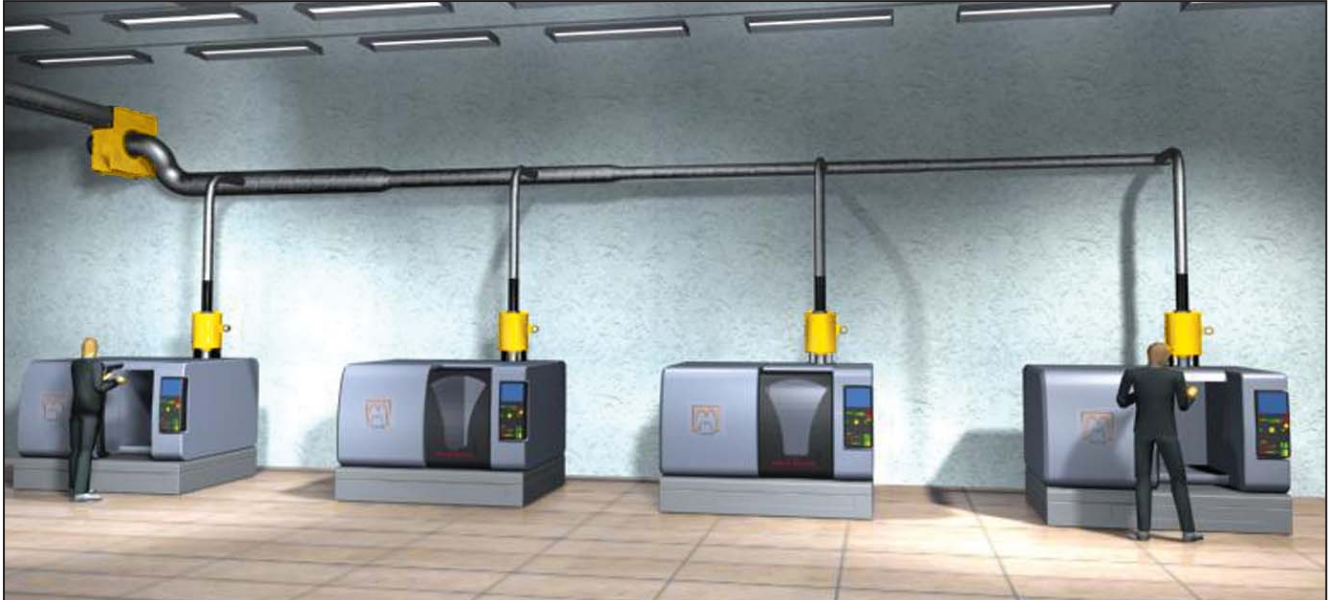
Impianto centralizzato con MistWizard™ montati direttamente a bordo macchina
